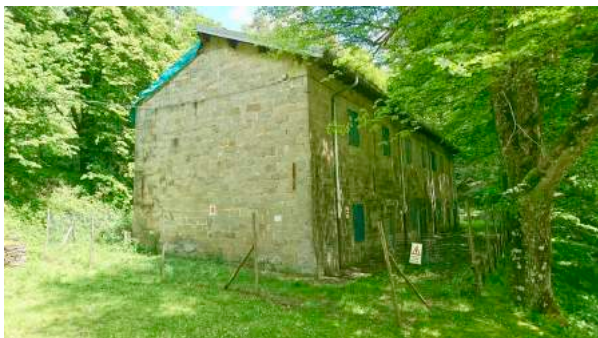
Vecchia foresteria, oggi pericolante
